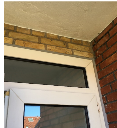
Kuldebro ved altanvægge og gulv
