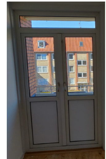
Altandør med utætheder
